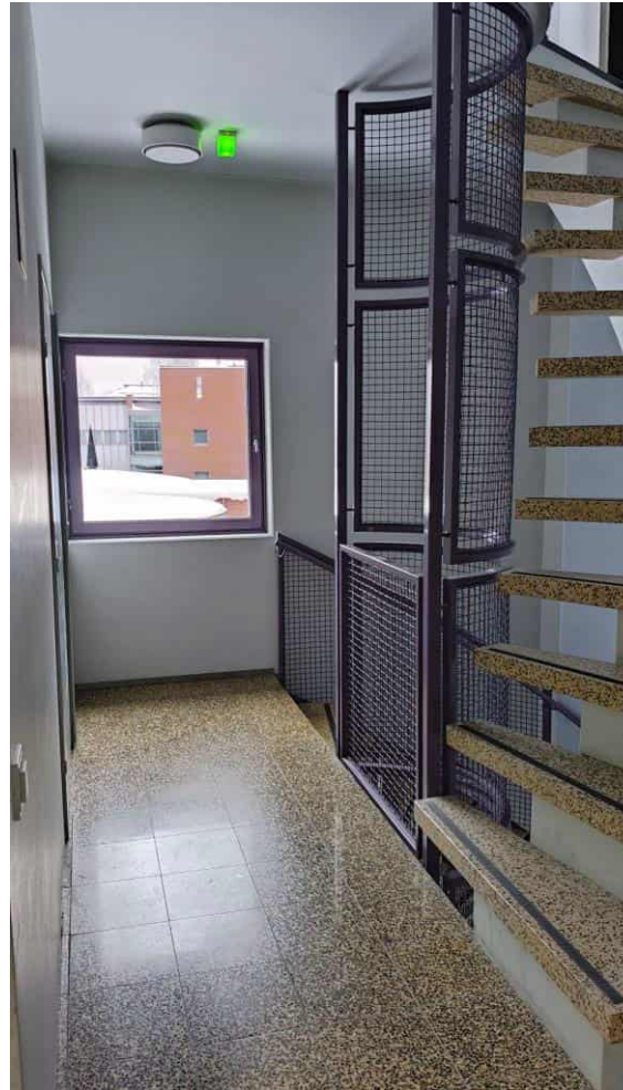
Kuva 73. Porrashuone C326. Itä- ja länsi-siivissä on kierreportaat ensimmäisestä kerroksesta ullakolle ja katolle. Niiden metalliverkkokaiteet muodostavat portaan keskiosaan jatkuvan rakenteen.
